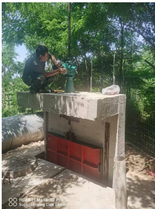
熊岳河雨水排放口应急阀门
