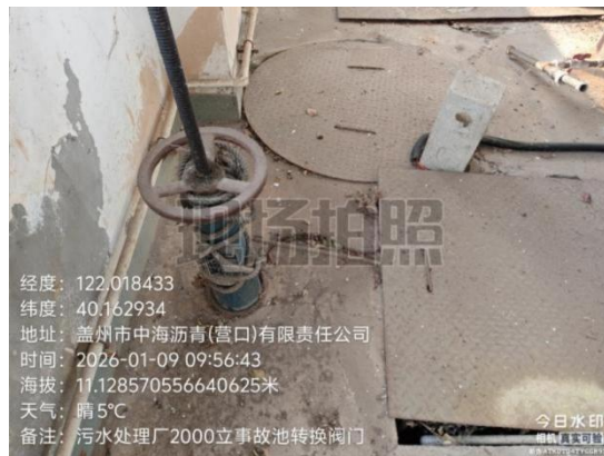
事故废水转换阀门 (2500m³)
