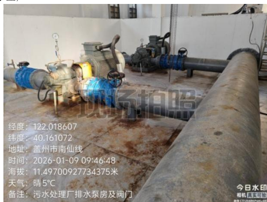
污水处理厂污水排口阀门
