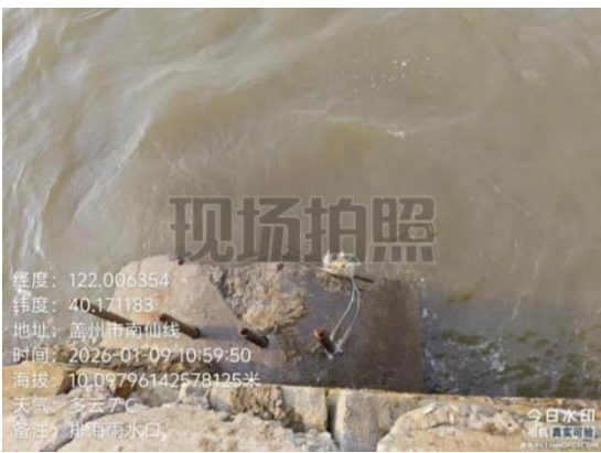
入海雨水排放口应急阀门
