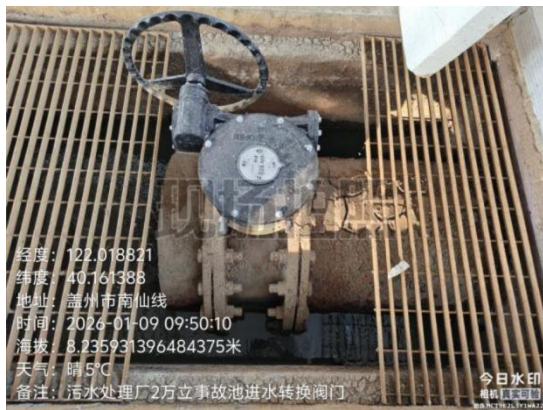
事故废水转换阀门 (20000m³)
